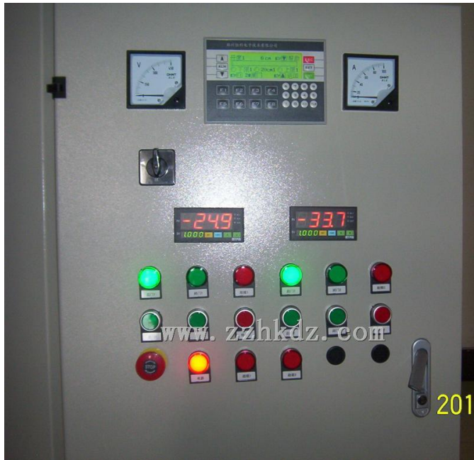
启闭机控制柜
